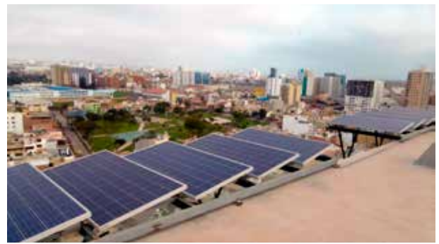
Figura 6. Uso de paneles solares que alimentan a parte de las áreas comunes del edificio.
